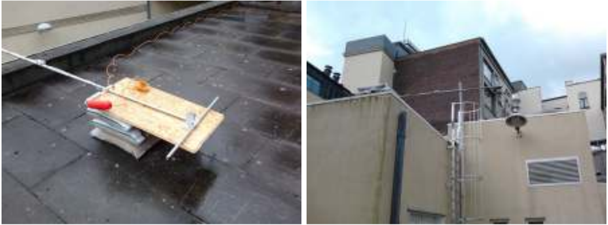
Figuur 7 : Enkele detail foto's van de installatie van de logger achteraan de AMRP-UGent gebouwen.
