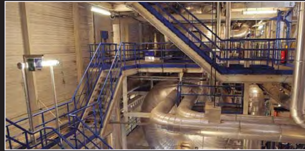
Kerncentrale EDF Golfech (Frankrijk) - foto SAMMODE
