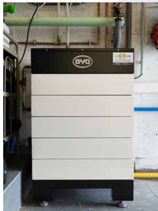
Eén van de batterijen die geïnstalleerd werden bij de deelnemers van het cVPP-project.
