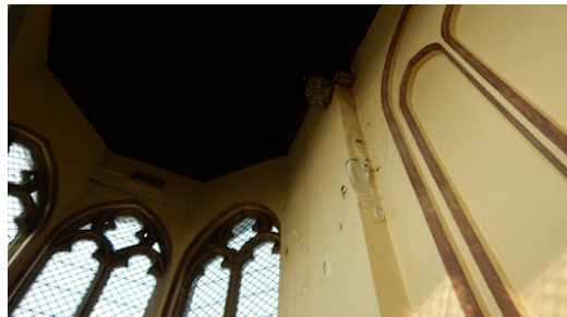
Schade aan de afwerkklagen in het interieur.
