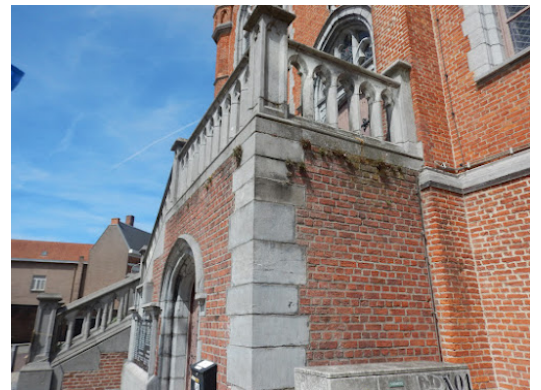
Plantengroei in het voegwerk van de gemetselde trap.
