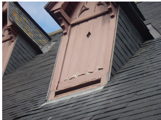
Detail schilderwerk dakkapel hoofddak [2]. De verf bladdert af.
