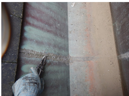
Detail losse soldeernaad. Deze naad werd voorlopig afgedicht tijdens de inspectie.
