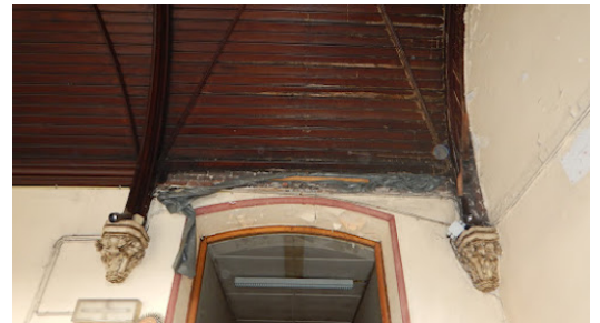
De kroonlijst van het houten plafond is gedeeltelijk weggevallen, als gevolg van vroegere lekkages.
