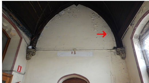
Gevolgschade interieur thv dak [4].
