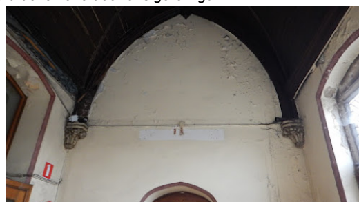
→ (oude) gevolgschade in het interieur. De afwerklaag komt op verschillende plaatsen los.
