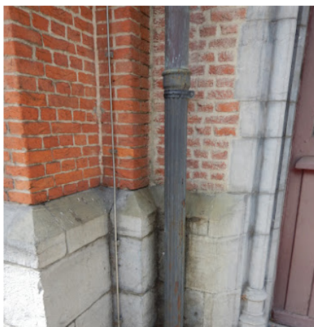
Roestdoorslag thv de gietijzeren standpijp
