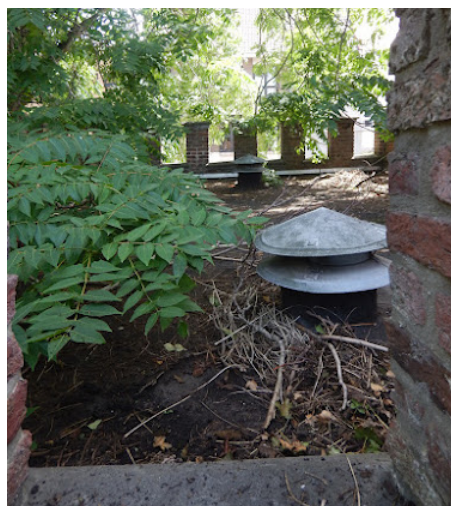
Platte daken bijgebouwen achterzijde. Het regelmatig snoeien van de overhangende boom kan het onderhoud van deze daken sterk bevorderen.
