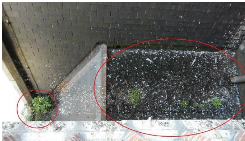
Thv dak [4] (grote cirkel) en vooral in het klein stukje bakgoot (kleine cirkel) bevond zich opnieuw een dik pakket duivenmest en planten. Ook tijdens de vorige inspectie werd deze zone door ons gereinigd.
