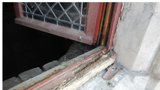
Detail inrotting van de houten raamdorpel.
